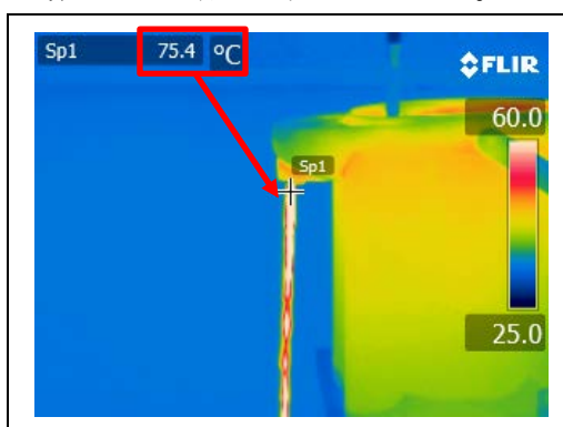
写真 1. 漏れ出したお湯の温度確認
