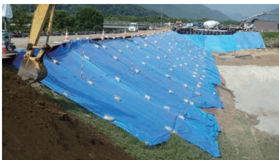
写真 小田川の堤防決壊現場(2018年7月20日)
