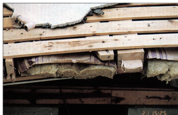
写真 接合部に金物がないと容易に外れる
