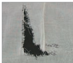
写真2 写真1の破損部拡大
