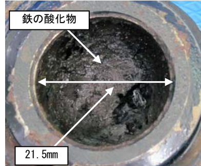
写真 4. ケース内の錆(鉄の酸化物)
