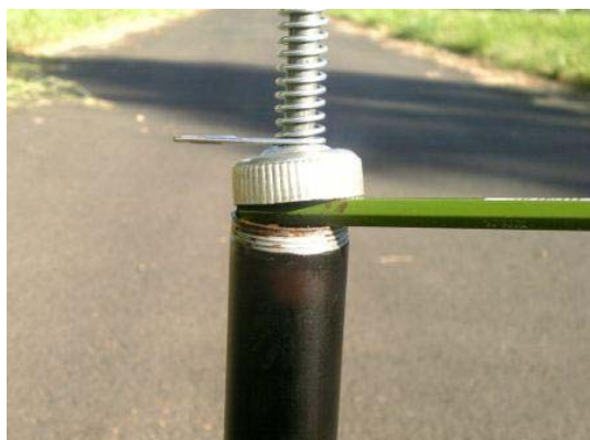
写真 3-a. 隙間に鉛筆を挟み込んだ様子
