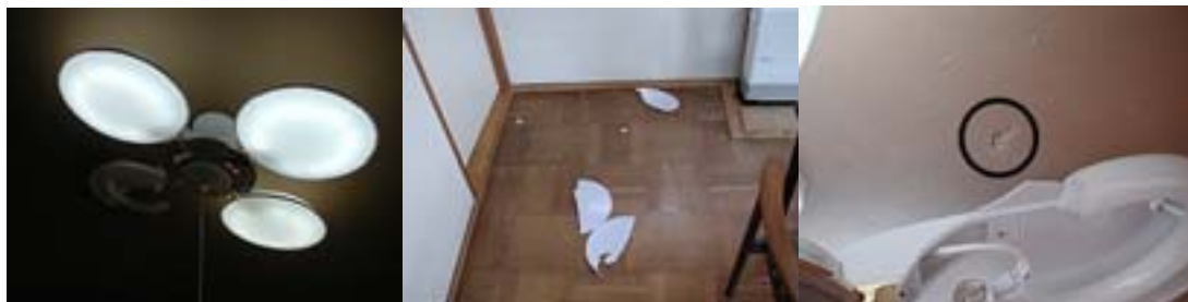
写真 5. 照明器具の破損状況
